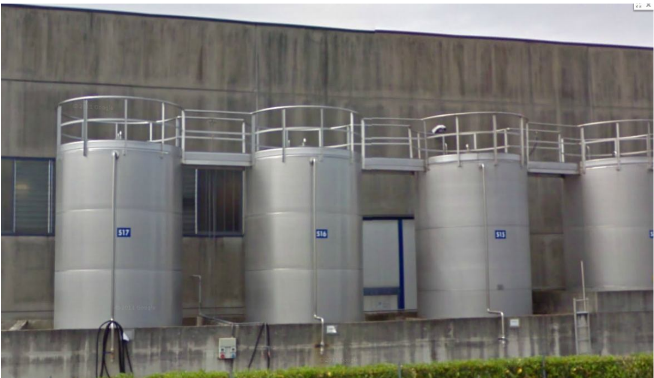
Serbatoi utilizzati per il trattamento in progetto (da sinistra: S17, S16, S15)
