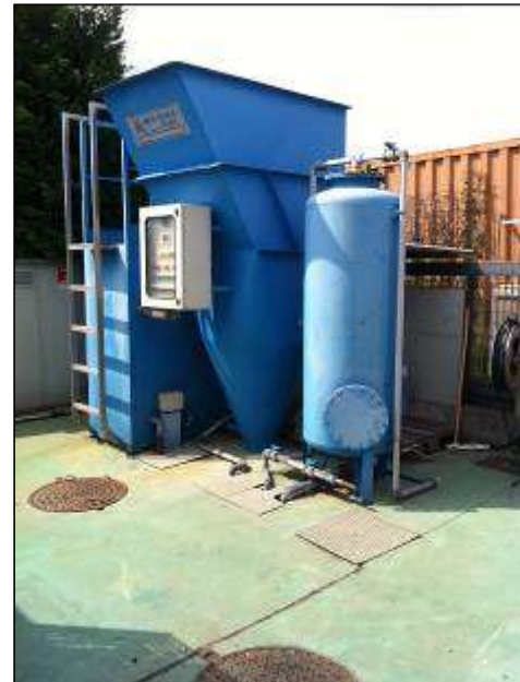
Fig. 27: Impianto di depurazione chimico-fisica
