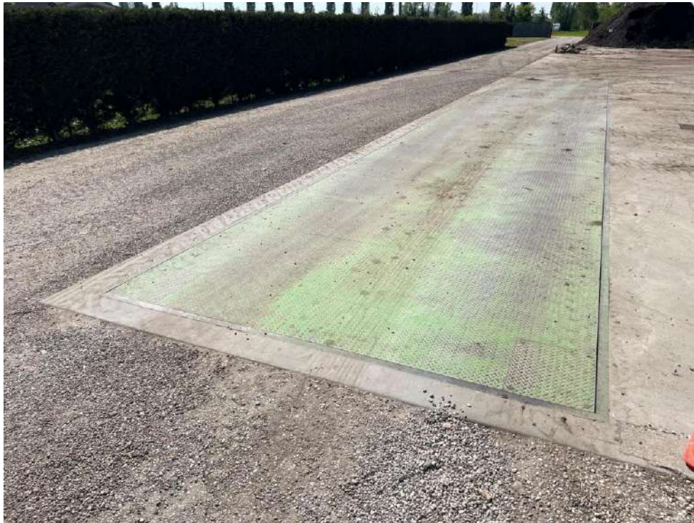
Fotografia 14 – Pesa a fossa in dotazione all'impianto
