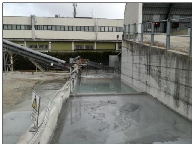
Fig 10: Vasche accumulo acque meteoriche di dilavamento
