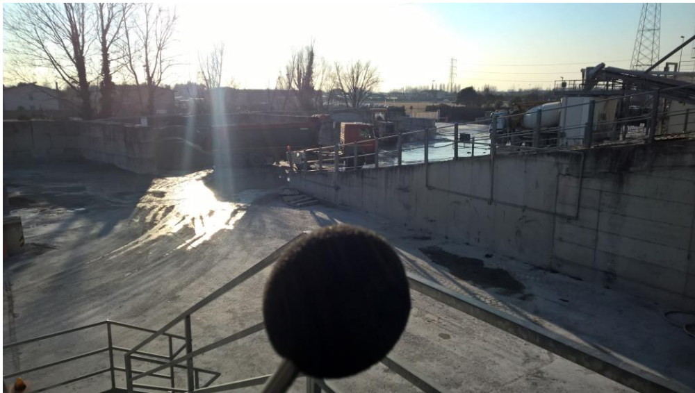
Vista da Posizione #1 su rampa di carico inerti e stazione di carico autobetoniere
