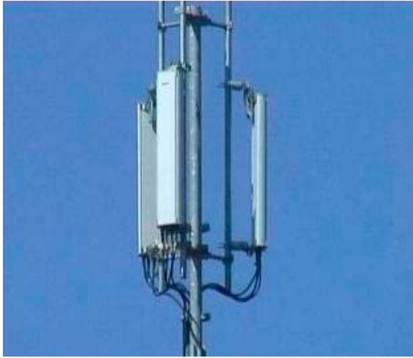
1-Sistema di antenne montato su palo
