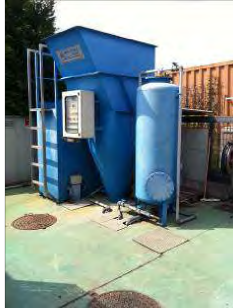
Fig. 16: Impianto di depurazione chimico-fisica
