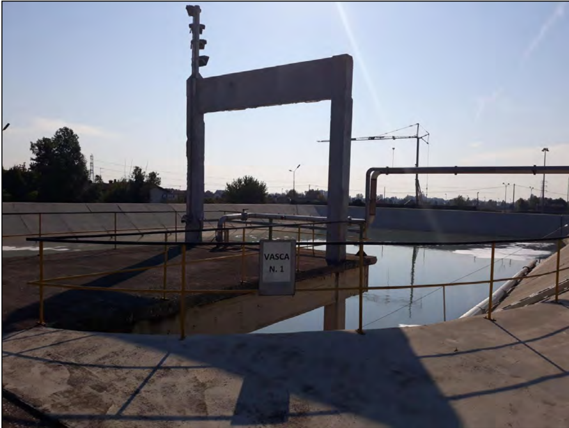
Figura 17– Vasca di accumulo n°1 con tubazione di mandata all'impianto di depurazione.
