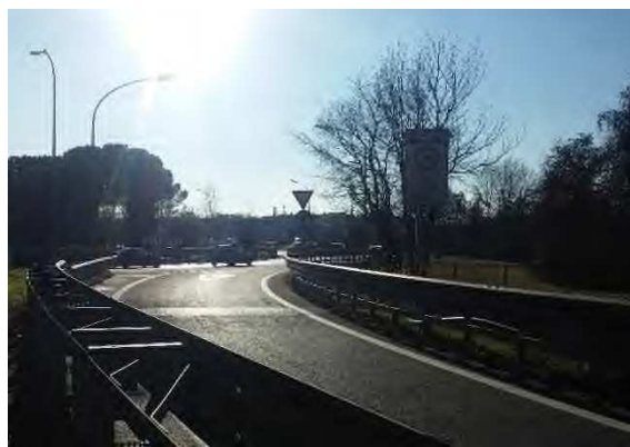
Figura 26 – Rampa nord Tangenziale
