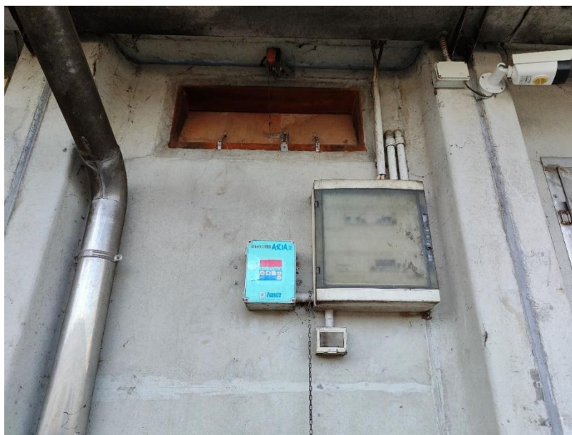
Foto 25 : Finestra di ingresso dell'aria nella Stalla nuova lato sud 10 settori con con rilevatore della temperatura interna e centralina di apertura
