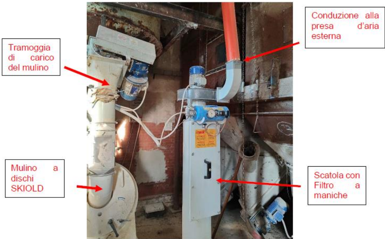
Foto 18. Mulino SKIOLD installato
