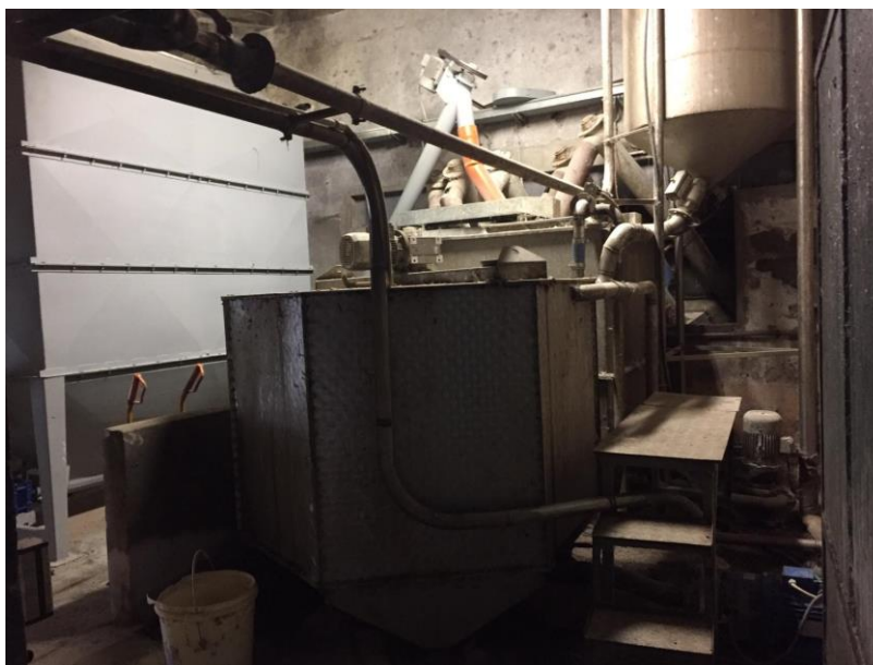
Foto. 3. Vasca in acciaio per la preparazione della broda per i suini e impianto di distribuzione automatizzato
