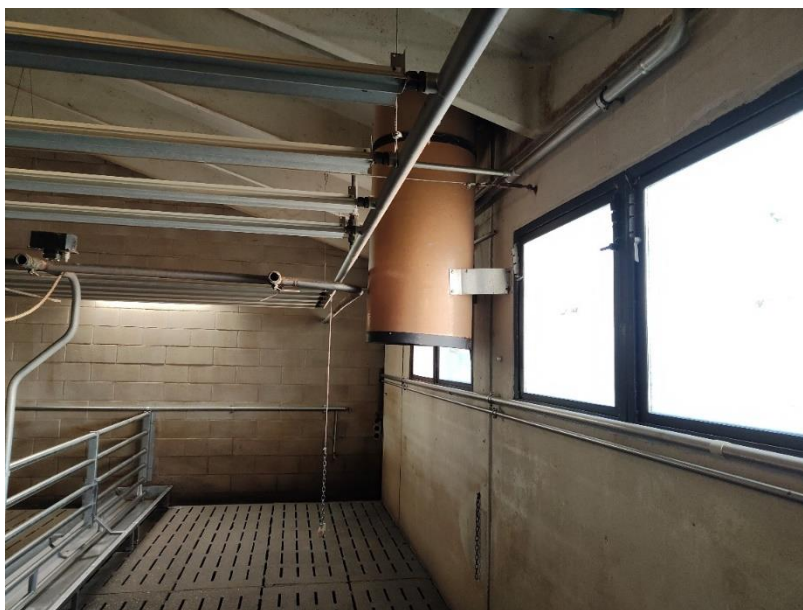
Foto 26: Presa di aspirazione dell'aria nella Stalla nuova lato sud 10 settori
