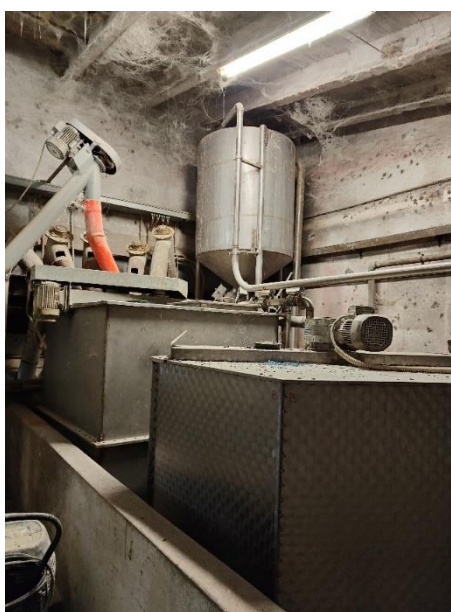
Foto. 20. Vasca in acciaio per la preparazione della broda per i suini e impianto di distribuzione automatizzato
