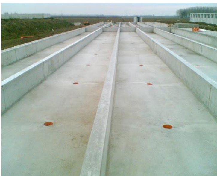
Fig. 12. Fori di fondo della vasca del sistema di svuotamento dei liquami vacuum system
