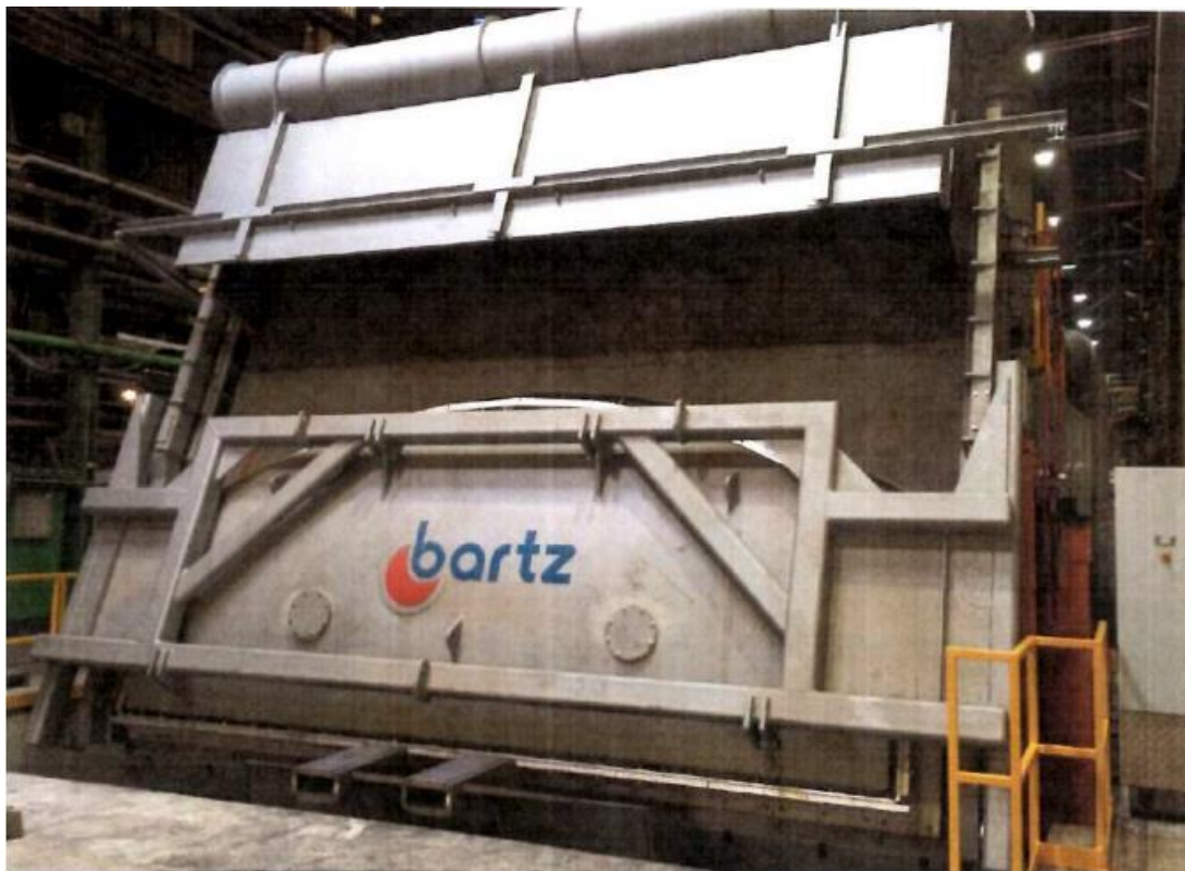
Foto 9: nuovo forno fusorio "H2"
