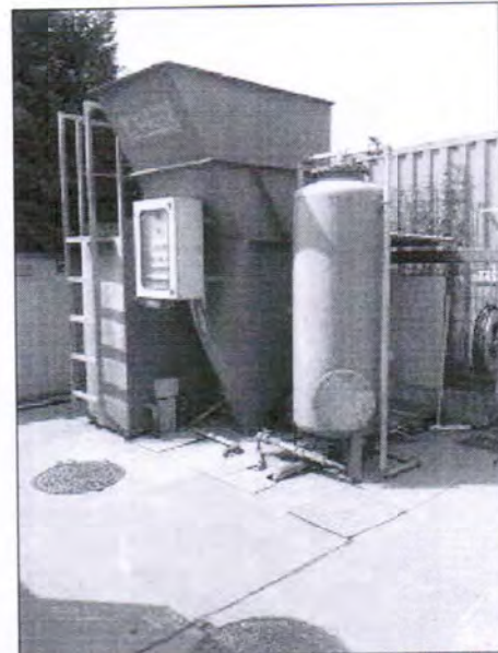
Fig. 17: Impianto di depurazione chimico-fisica
